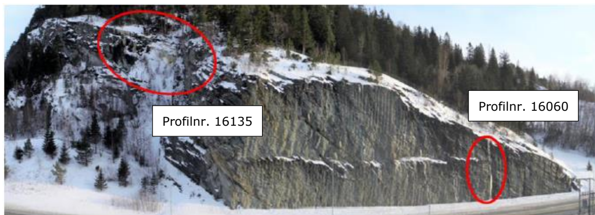
Figur 31: Isskjøving og isdannelse ved eksisterende bergskjæring.
