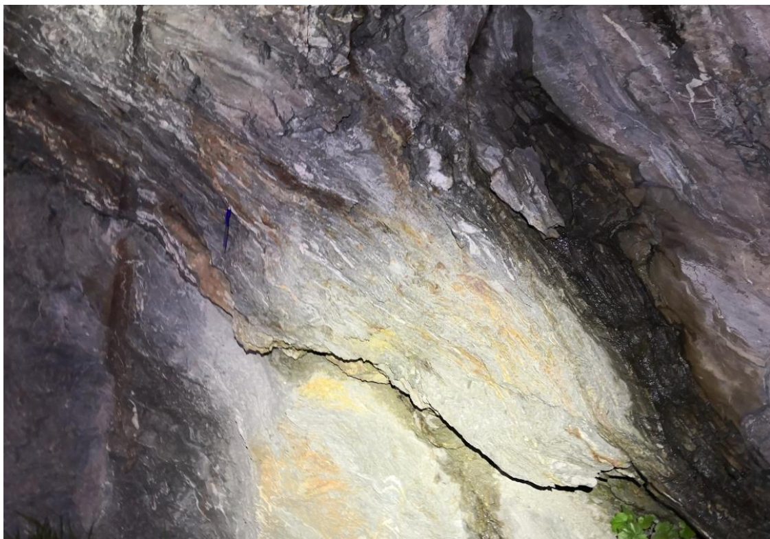
Figur 41: 0,3 m tykk sone med synlige sulfidmineraller observert ved eksisterende bergskjæring.
