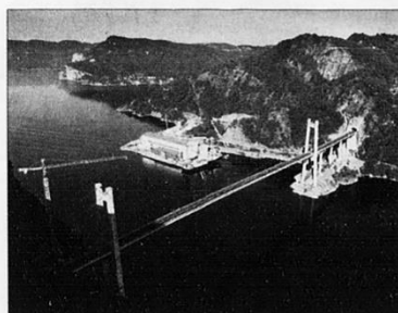
FEDAFJORDEN BRO: Med en seilingshøyde på 50 meter vil skiptrafikken gå som normalt til Øye smelteverk under nye E 39. Flekkefjord Slipp & Maskinfabrikk til venstre.
