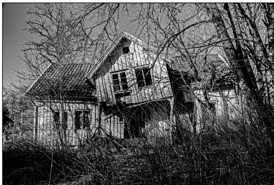
Figur 7-235: Våningshuset på Store Meland (SEFRAK 1037-0014-051) står til nedfalls. Foto: Jan Adriansen, Sweco.
