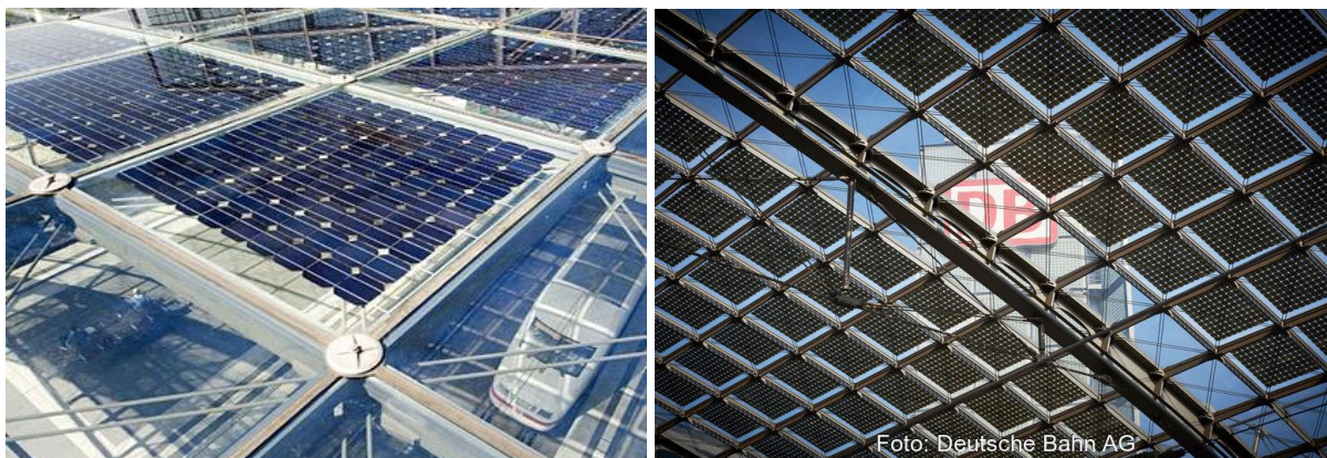
Figur 38: Glassintegret solcelleanlegg i taket på togstasjoner. Foto: Deutsche Bahn AG.
