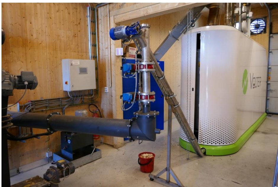
Figur 22: Skruereinmating av skogsflis til kraft-varmemaskin på Høyskolen i Innlandet, avd. Evenstad. Anlegget eies og driftes av Statsbygg. Foto: Multiconsult
