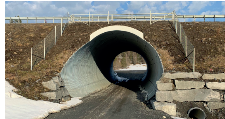
Enkel stålørskulvert for de mindre krysningene under veien. Foto: Viacon.
