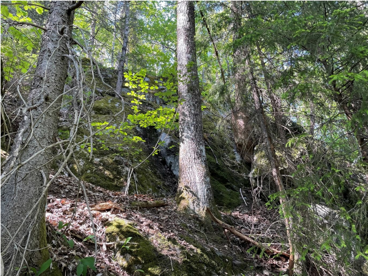
Figur 7-5: Avløste blokker i skråning til venstre for hovedveien, ved ca. profil 6600. Fotograf Ingvild Sangesland Qvist.
