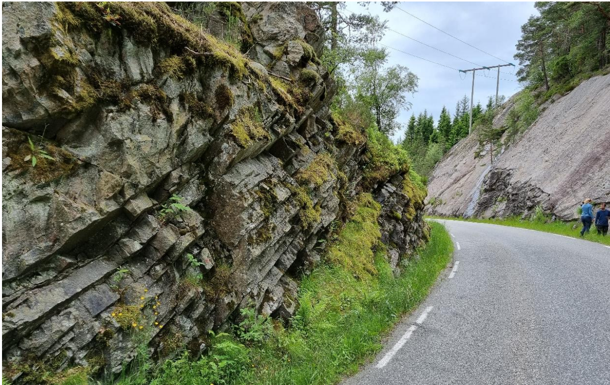
Figur 5-7, Tett oppsprekking langs foliasjonen ved skjæring Åsevegen.
