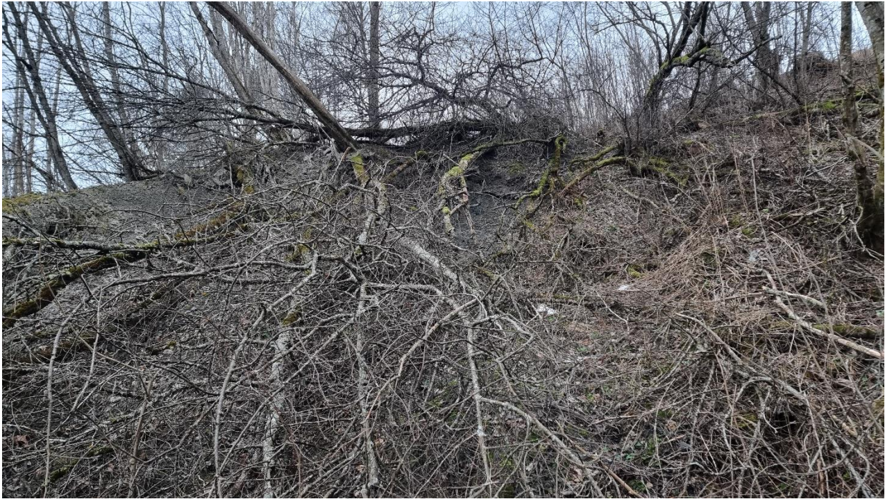
Spor etter bevegelse i massene i skråningen over elva.
