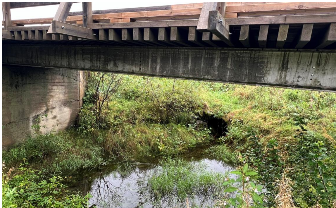
Figur 7-2. Det ligger allerede i dag et rør på under rundkjøringen. I dag går det ikke nevneverdig vann i dette. Diameter på røret er uansett for liten til å oppnå ønskede restaureringseffekter i Veslegausa.
