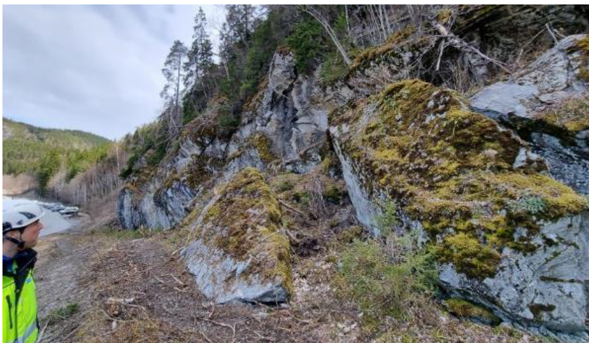
Figur 31: Utfall fra nedre klippeområde som ligger på anleggsvegen mellom Hommelvikkrysset og eksisterende høye bergskjæring. Det er observert flere utfall som ligger på anleggsvegen. Blokkstørrelser er i størrelsesorden 5-30m 3 .
