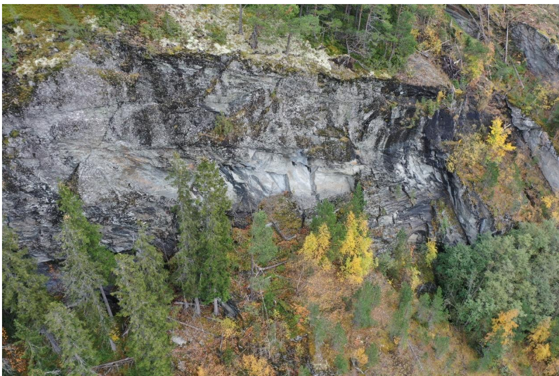
Figur 13: Klippe i hjørnet rett nord for eksisterende høye bergskjæring, dvs. klippe under terrenget som er vist i Figur 12. Det er tegn til nylig utfall i klippene, og det er observert blokker i terrenget i underkant, se Figur 14.
