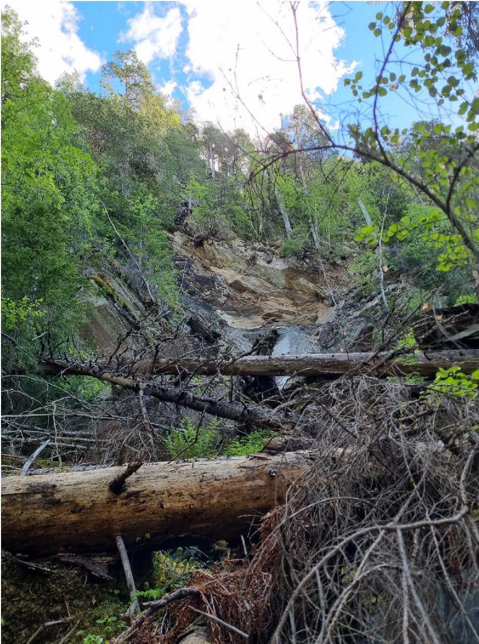
Figur 15: Skredrenne over Hommelvikkrysset. Her der det tydelig tegn på jevnlig aktivitet.
