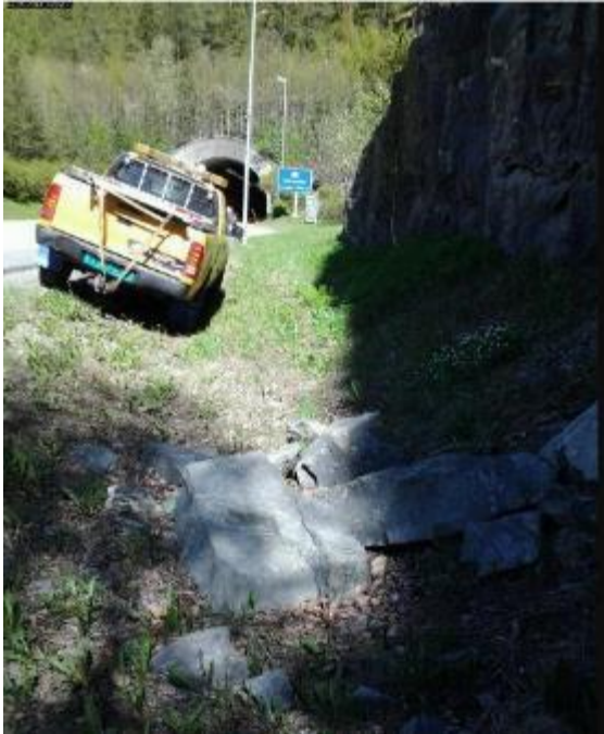
Figur 17: Foto fra vegkart.no. Steinspranghendelse med nedfall fra skjæring. Nedfall i grøft.
