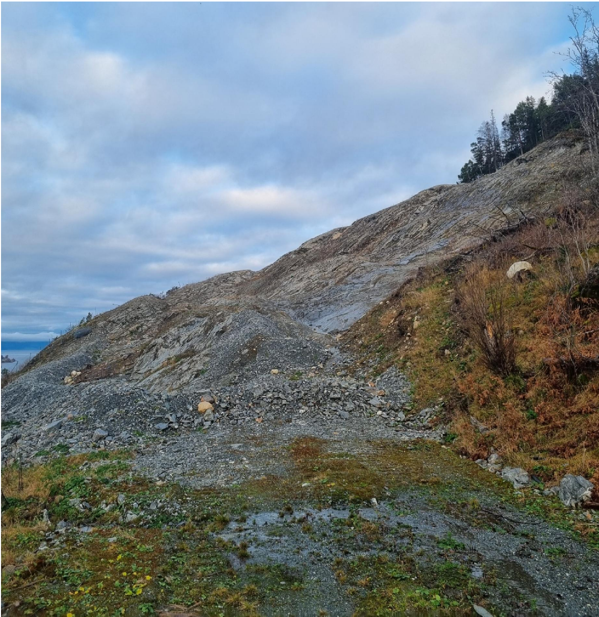
Figur 11: Figur 10: Terrenget over eksisterende høye bergskjæring etter avtaking av vegetasjonsdekket. Det er lagt opp en midlertidig voll som er synlig lengst til venstre i bildet.
