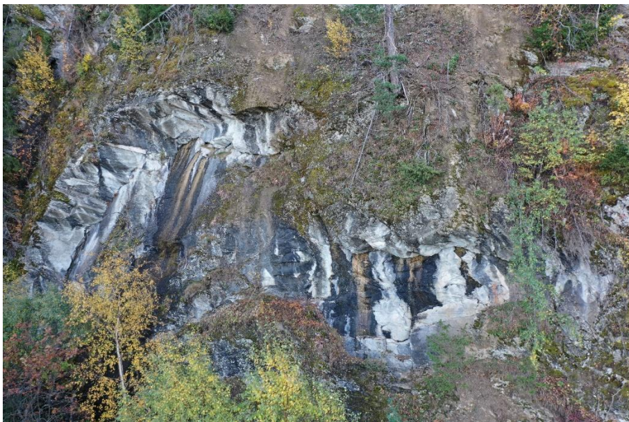
Figur 3: Omtrent samme område som Figur 2, og rett over Hommelvikkrysset. Synlig jevnlig aktivitet med utglidning av løsmasser. I dette området er det registrert en større steinsprang/jordskred-hendelse i september 2012.
