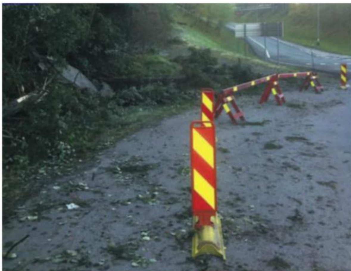
RAS: Ved pendlerparkeringen ved Helltunnelen raste det ut jord.
