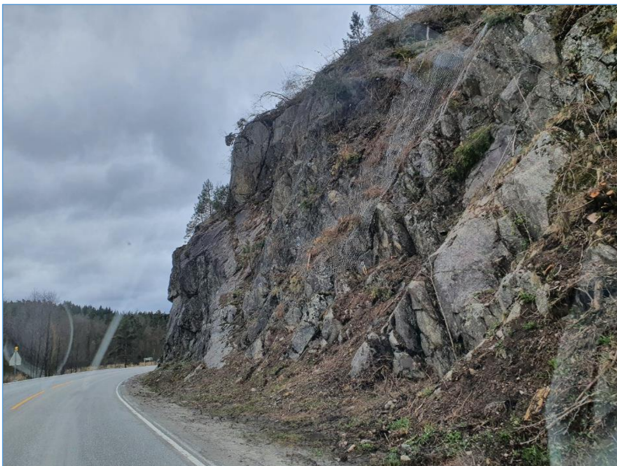
Figur 9: Eksisterende bergskjæring langs Fv.455 Marnarveien. Ny skjæring blir liggende omtrent 10 m lenger inn mot vest. Bildet er tatt mot sør.
