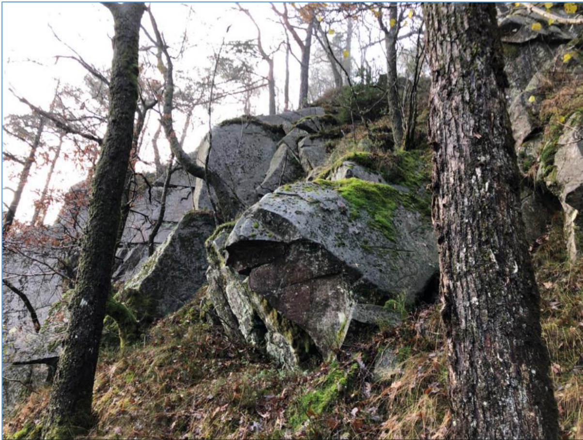
Figur 64: Avløste blokker under vestre landkar for brua.
