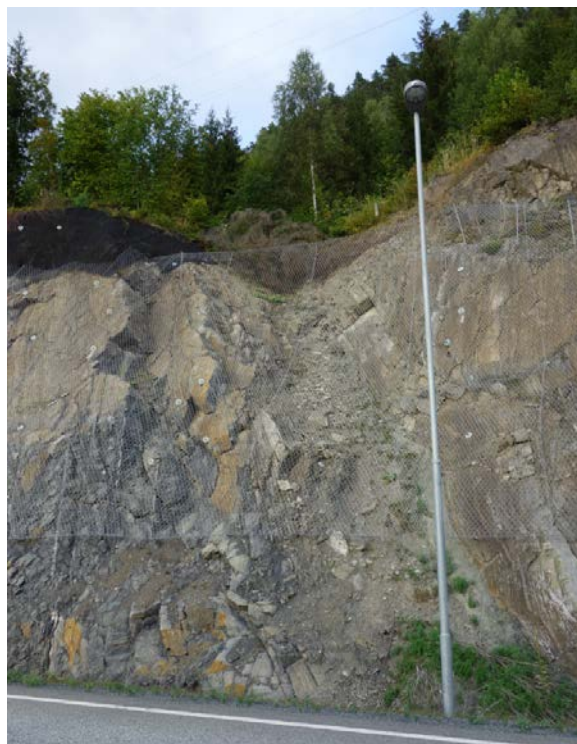
Figur 46 Rassikring på dagens veg med geonett boltet fast til fjellet
